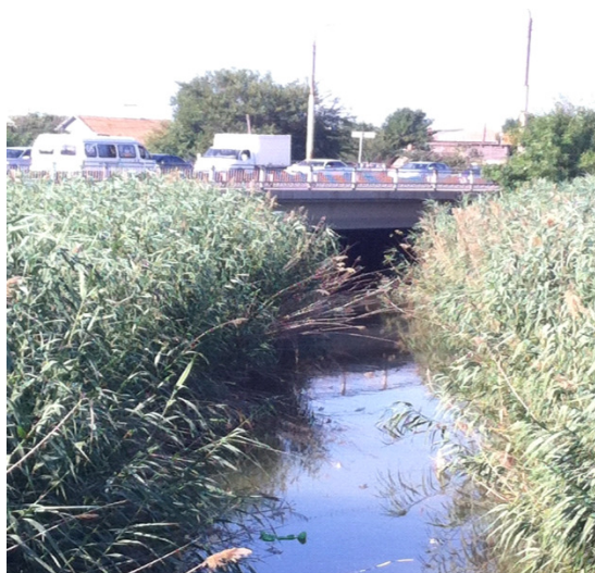
Рис.2. Состояние ерика Коньга Трусовского района г. Астрахани
