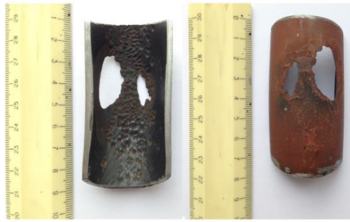
Рис. 1. Общий вид повреждения трубы испарителя низкого давления котла-утилизатора в районегиба [1]
