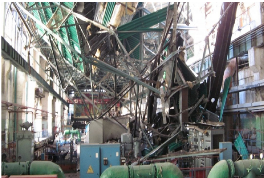
Рис. 2. Обрушение крыши в районе пятой турбины Пензенской ТЭЦ
