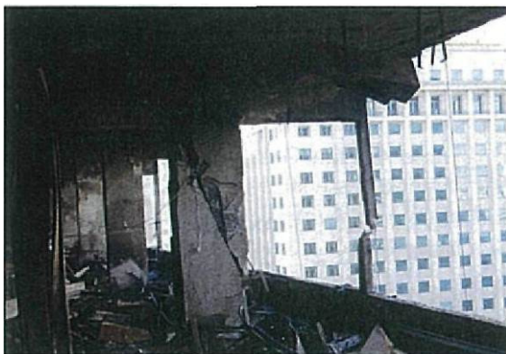
Рис. 2. Разрушение железобетонной колонны от сдвига, вызванного тепловым удлинением ригеля
