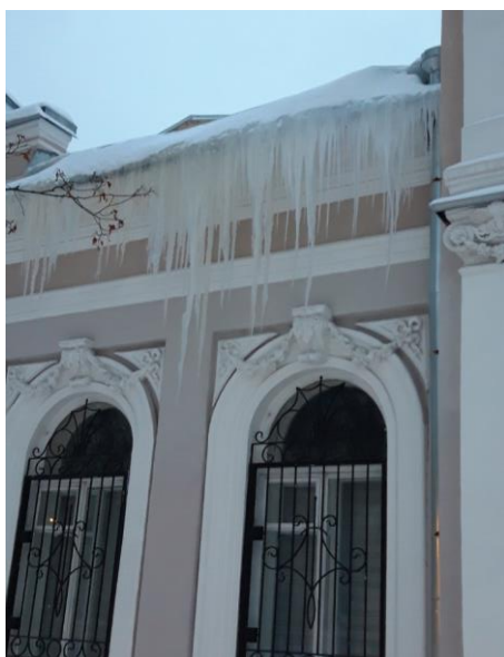
Рис. 1. Наледь на скатной крыше
