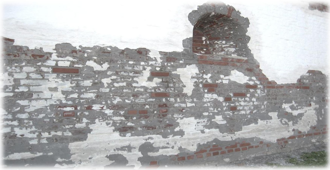
Рис. 1. «Капиллярная фильтрация» влаги стен Астраханского кремля
