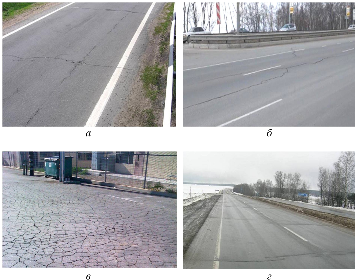
Рис. 2. Виды трещин в асфальтобетонных покрытиях: а – отраженные; б – технологические; в – силовые; г – температурные
