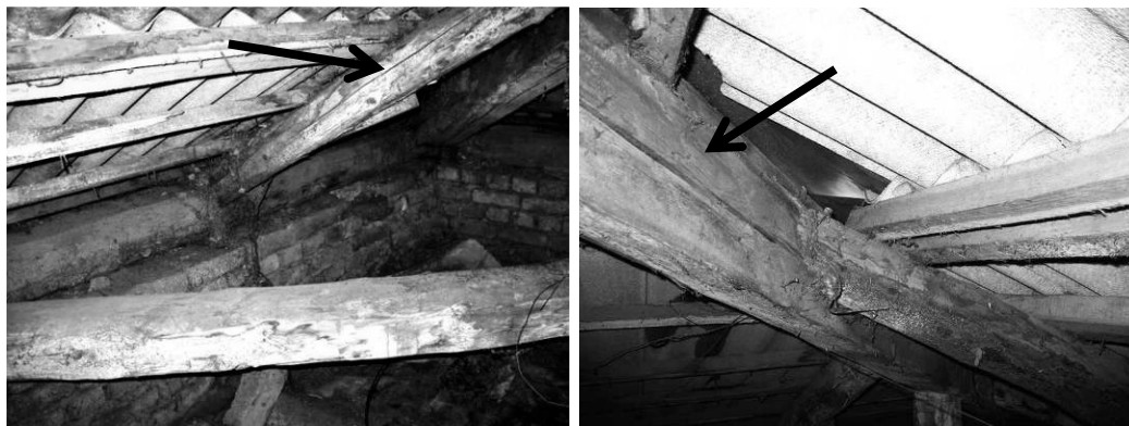
Рис. 2. Дефект элементов стропильной системы
