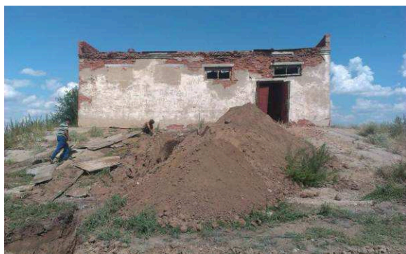
Рис. 3. Насосная станция первого подъема
