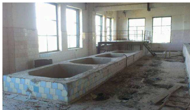
Рис. 4. Состояние скорых фильтров водоочистной станции
