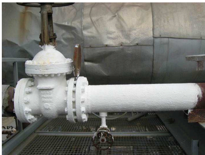
Рис. 1. Испытание теплоизолирующего покрытия «Корунд» на наружной поверхности трубопровода горячей воды Астраханского ГПЗ. Начало испытаний
