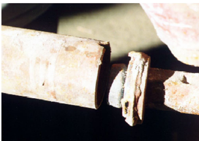
Рис. 3. Дефект изготовления – непровар сварного шва
