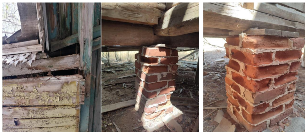
Рис. 13. Выветривание кладки столбов фундамента, отклонение их от вертикали, выпучивание и просадка отдельных участков столбов, полное разрушение наружного поверхностного слоя, выпадение отдельных кирпичей, отсутствие и выветривание раствора швов кладки
