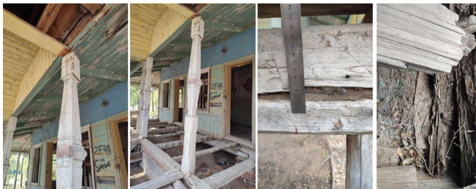
Рис. 12. Состояние и деформации несущих и отделочных деревянных элементов
