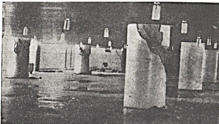
Рис. 1. Колонны гостиницы «Макуто Шератон», получившие повреждения при Каракасском землетрясении, 1967 г.
