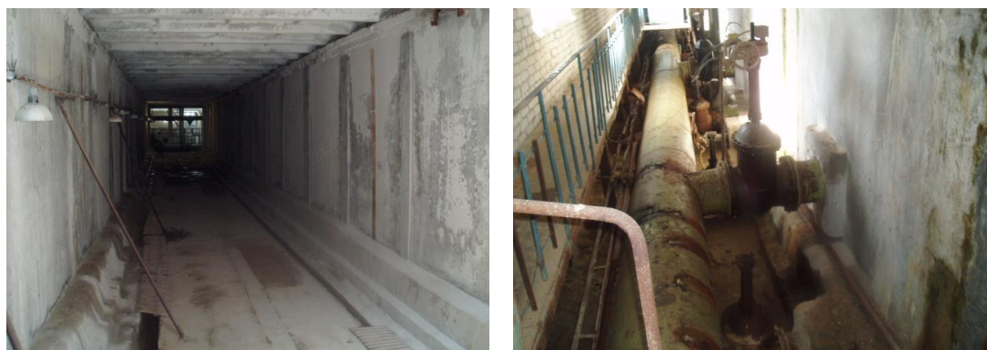
Рис. 1. Горизонтальные отстойники Ахтубинского группового водопровода
