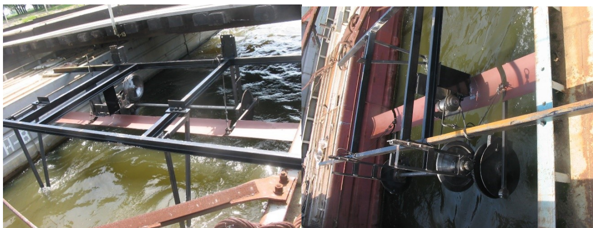
Рис. 2. Однолопастной модуль МикроГЭС, установленный на понтонах в речном потоке
