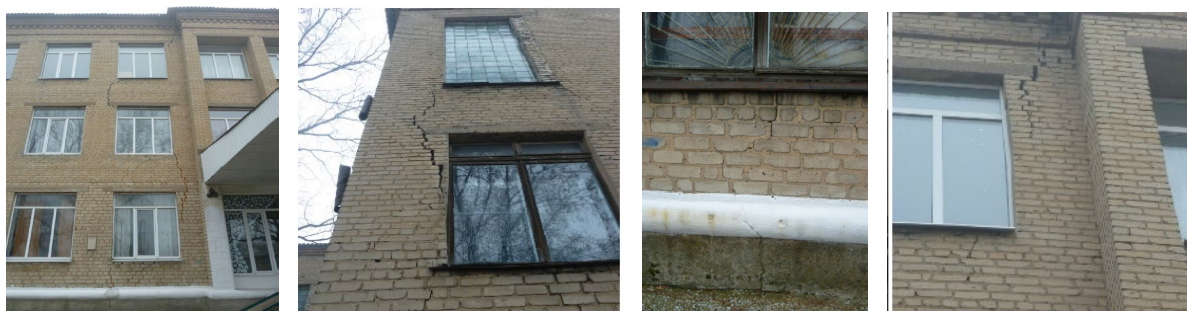
Рис. 1. Повреждения кирпичной кладки при неравномерной осадке здания
