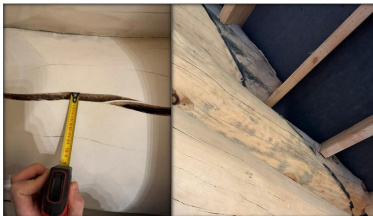
Рис. 5. Трещины и биопоражения древесины
