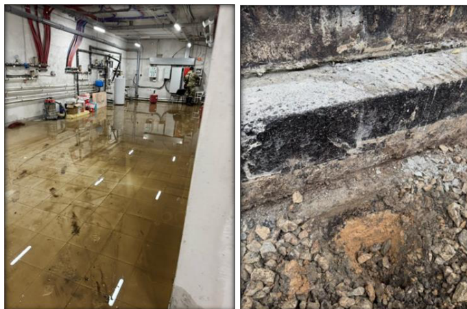
Рис. 3. Следствие некачественных гидроизоляционных работ
