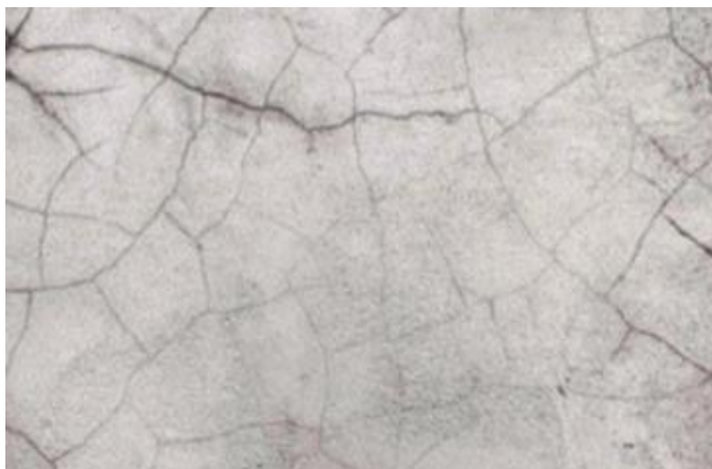
Рис. 2. Влияние сухого и жаркого климата на образование усадочных трещин [11]
