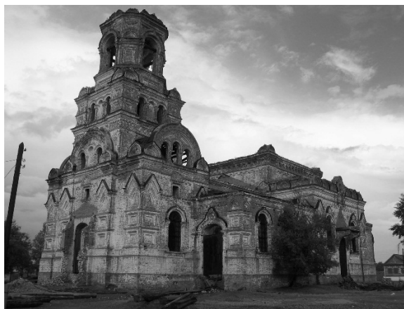
Рис. 1. Состояние памятника до начала реставрационных работ. Вид с юго-запада
