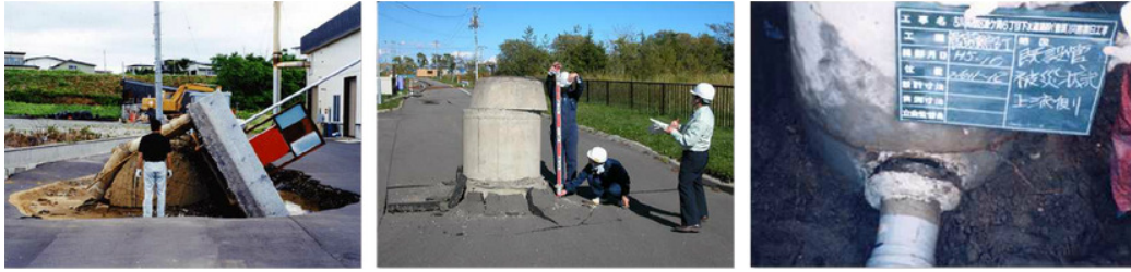
Рис. 1. Повреждения подземных сооружений из-за разжижения [12]
