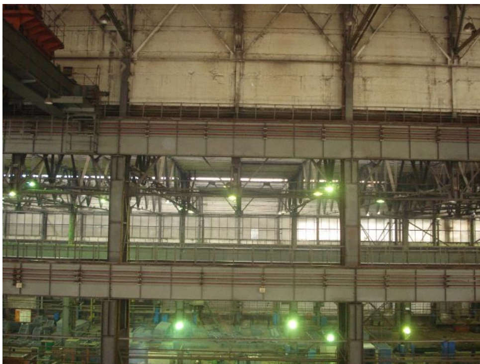
Рис. 5. Двухъярусные подкрановые пути (верхний крановый путь под два крана г/п 250 т каждый)
