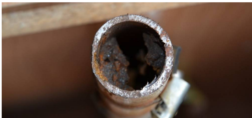
Рис. 3. Отложения в трубе
