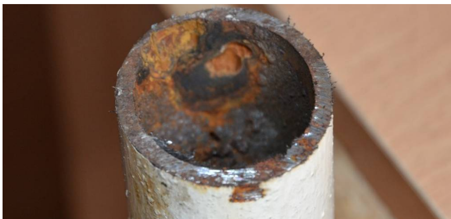
Рис. 2. Очаги точечной коррозии внутри трубы
