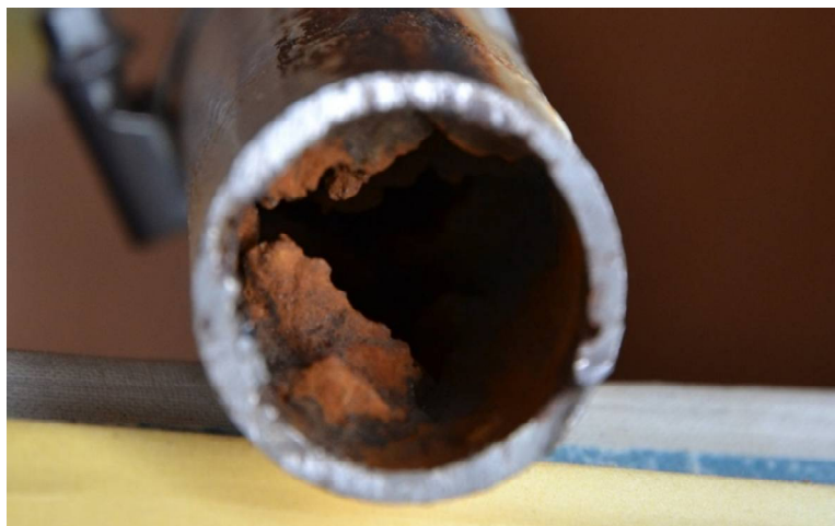
Рис. 4. Отложения в трубе
