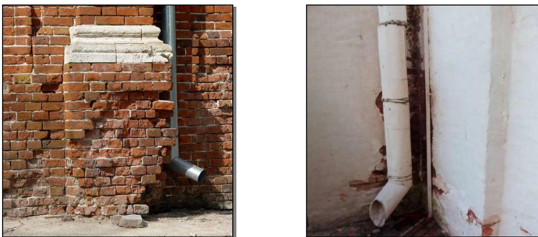
Рис. 3. Разрушение участков кладки в районе падения воды из водосточной трубы
