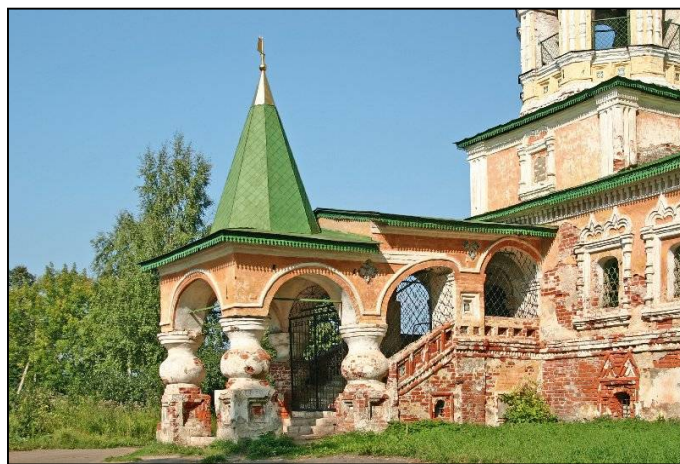
Рис. 5. Разрушение кладки крыльца Рождественской церкви в Угличе
