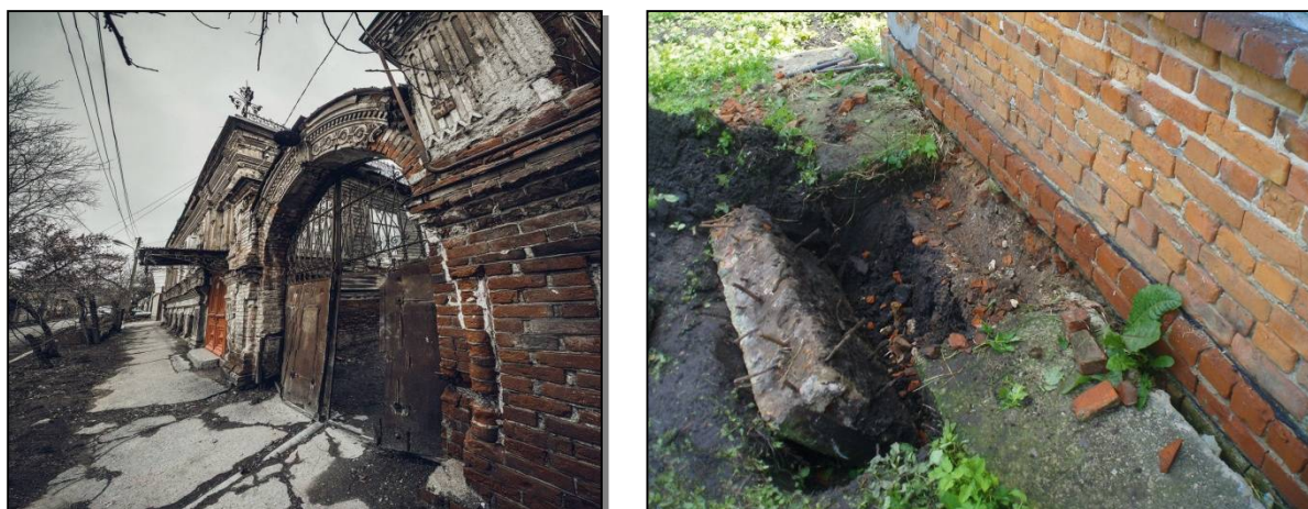
Рис. 4. Разрушение нижней части стены вследствие плохого состояния отмостки
