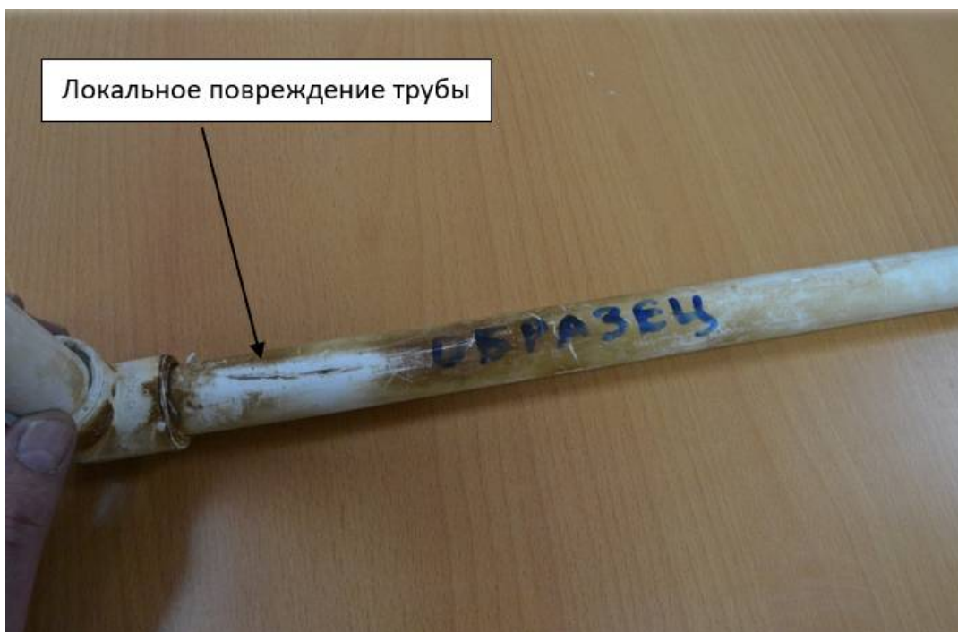
Рис. 1. Участок действующей системы отопления здания с локальным повреждением
