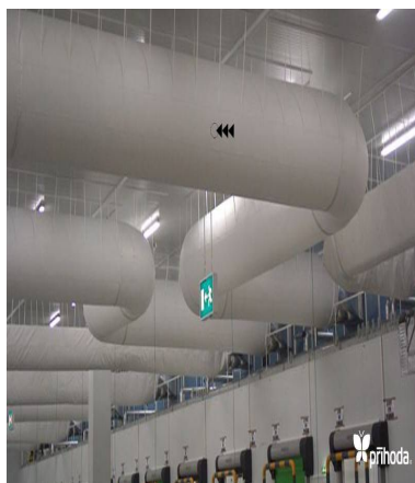
Рис. 2. Тканевые воздуховоды в гальваническом цехе мебельной фабрики
