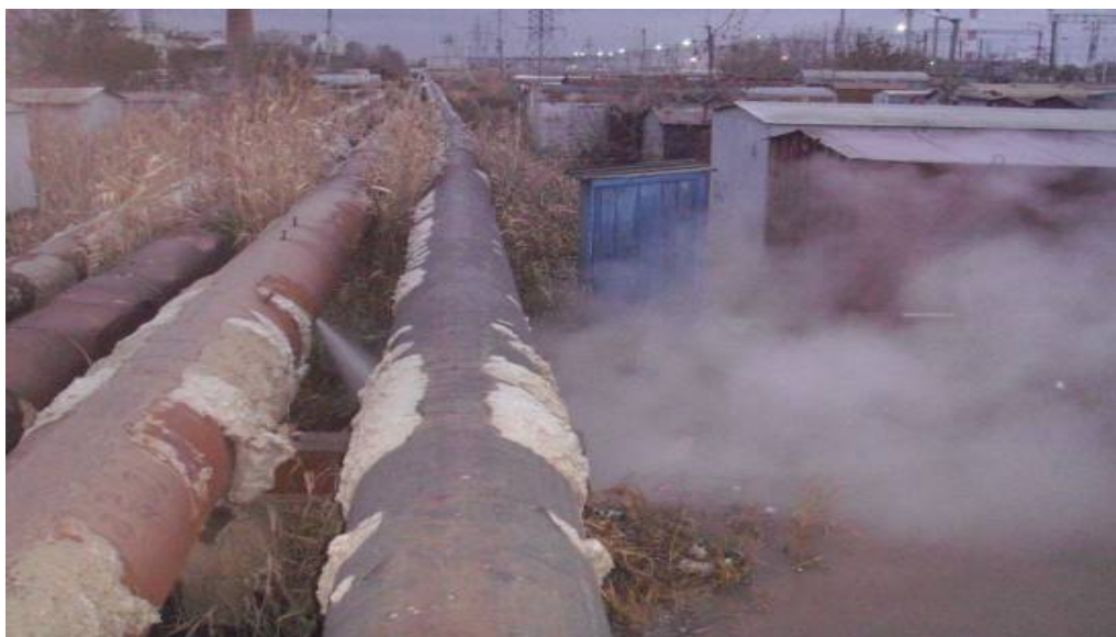
Рис. 1. Текущее состояние сетей теплоснабжения по ул. Звездная города Астрахани
