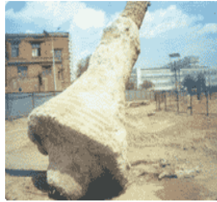
Рис. 13. Общий вид буронабивной сваи с уширением в форме полусферы, образованным разбуриванием грунта расширителем
