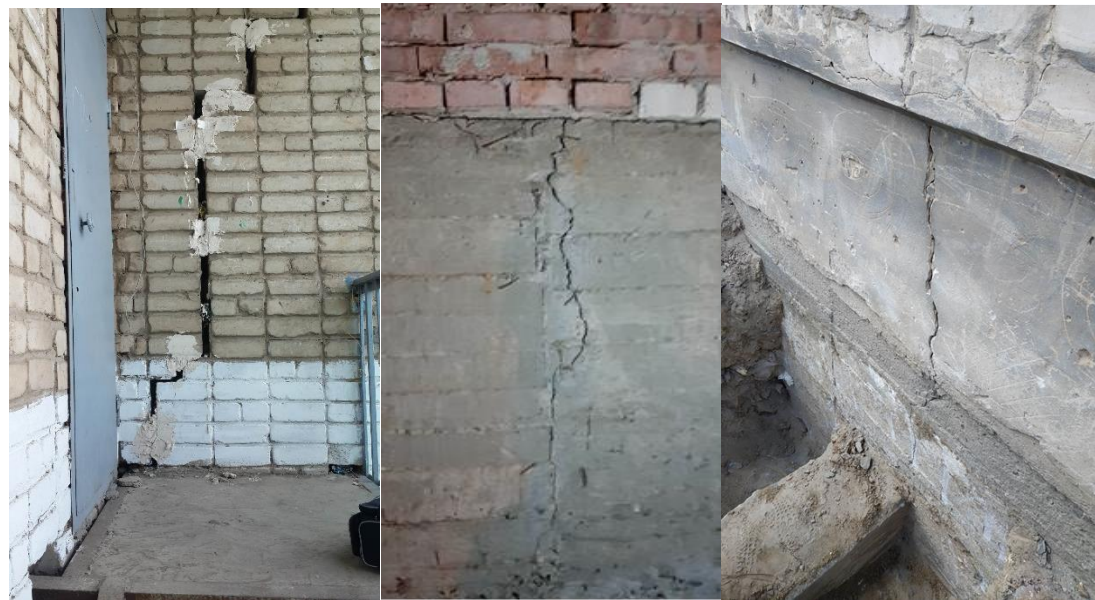
Рис. 2. Общий вид влияния сейсмических волн от транспорта на обследуемое здание и характер нарастания трещин в бетонном фундаменте и стенах от вибрации (с фотофиксацией)
