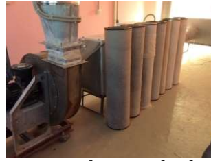
Рис. 6. Электроразрядные методы удаления ДПВ. Установка «Тион» (разрядный блок + каталитический блок) г. Новосибирск
