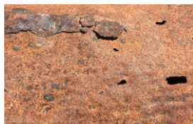
Рис. 1. Сквозная коррозия на элементе морской платформы
