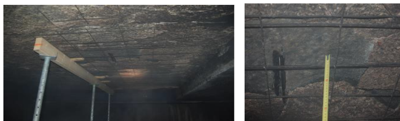
Рис. 3. Структурные повреждения конструкций после пожара автомобилей на автостоянке
