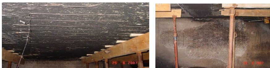
Рис. 2. Железобетонные перекрытия автостоянки после пожара
