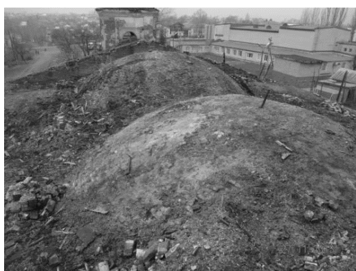
Рис. 2. Состояние кладки сводов покрытия. Кладка эксплуатируется в условиях особоагрессивной среды
