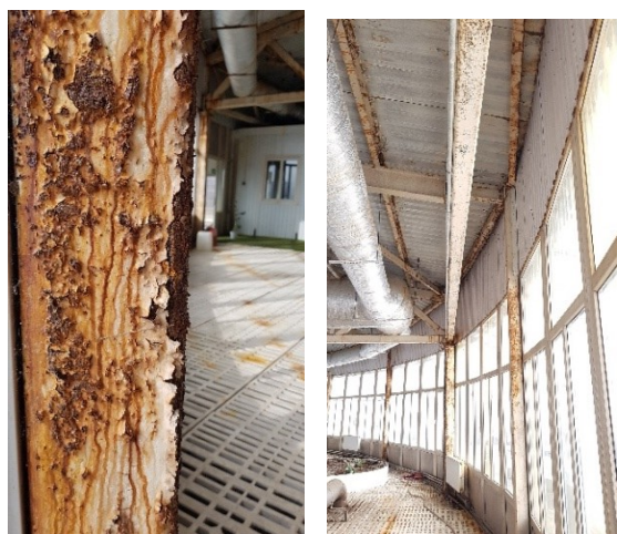
Рис. 2а, 2б. Коррозийные металлические конструкции в рабочей зоне перекрытых КОС «Суворовские»
