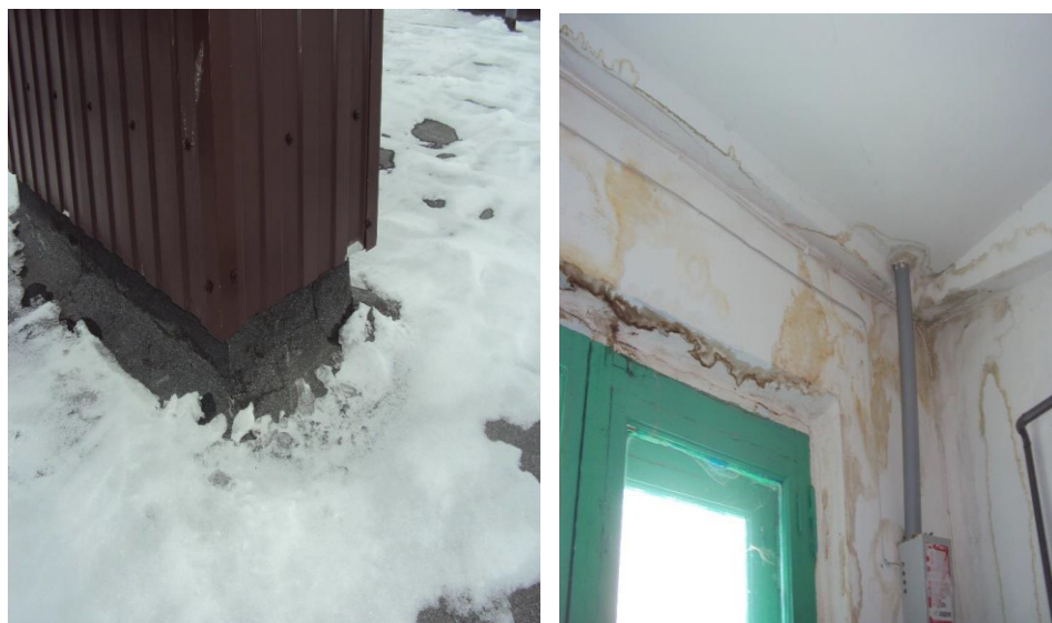
Рис. 4. Нарушения в отношении МКД в г. Камышин.
