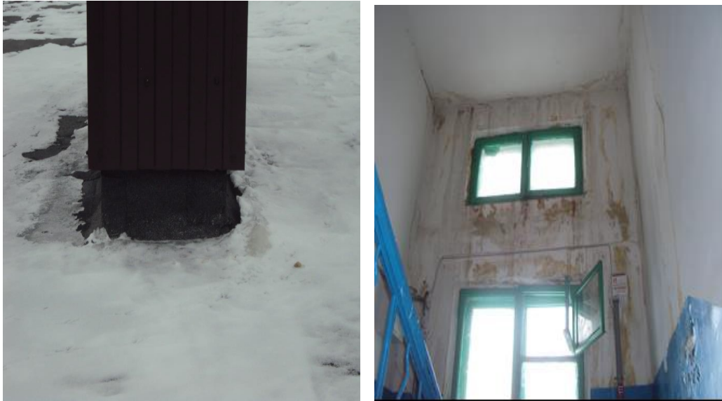
Рис. 5. Нарушения в отношении МКД в г. Камышин
