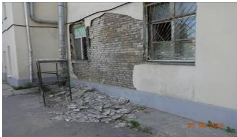
Рис. 7. Неисправленные нарушения, описываемые в примере 2.
