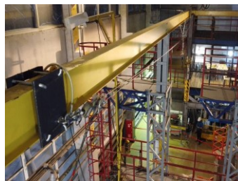
Рис. 2. Пример установленной гибкой анкерной линии
