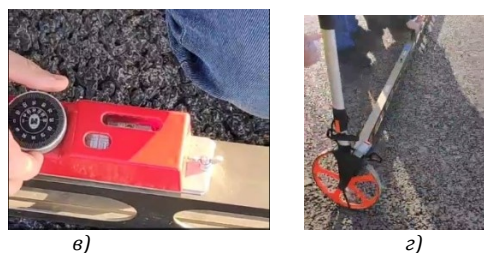
Рис. 1. Измерение дефектов дорожного покрытия от необратимой деформации с использованием дорожной рейки (а-г)
