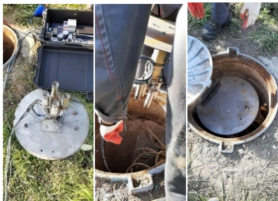
Рис. 1. Фрагменты газоанализатора, блока обработки данных и антенны для передачи данных при установке в колодце
