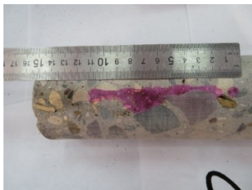
Рис. 2. Карбонизация бетона на образце-керне
