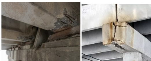
Рис. 1. Примеры разрушений: а – торца балки; б – е ригеля
