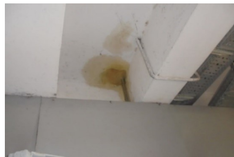
б) масляные следы на поверхности плиты перекрытия
