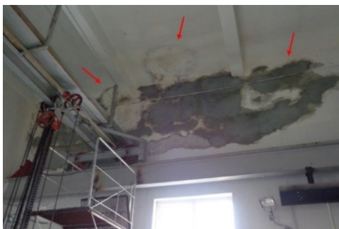
а) следы замачивания в плите перекрытия
