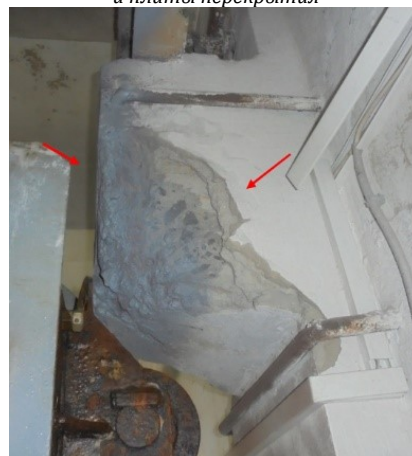
е) повреждения (сколы) защитного слоя бетона колонны. Локальные повреждения защитных и отделочных покрытий
