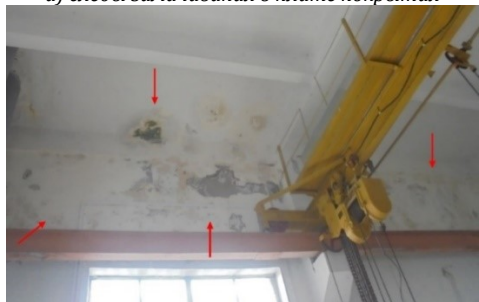
в) следы замачивания, разрушения защитного покрытия
