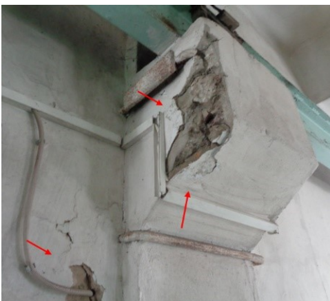
д) повреждения (сколы, трещины) защитного слоя бетона колонны. Локальные повреждения защитных и отделочных покрытий
