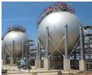
Рис. 3. Пример сооружения, защита опор которого от прогрессирующего обрушения возможна общепринятыми конструктивными мероприятиями. Емкостная часть может быть защищена только организационно-техническими мероприятиями (газгольдер высокого давления шаровой)
