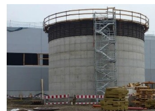
Рис. 2. Пример сооружения, защита от прогрессирующего обрушения которого конструктивными мероприятиями невозможна (емкость вертикальная, железобетонная)
