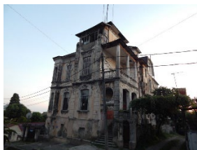
Рис. 1. Дом Гофмейстера Его Императорского Величества князя Георгия Дмитриевича Шервашидзе (Чачба), ул. Джанашиа, 23, г. Сухум
