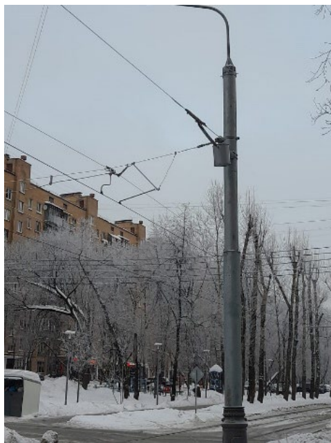
Рис. 4. Грузовой компенсатор контактной сети трамвая с аварийным тормозом
