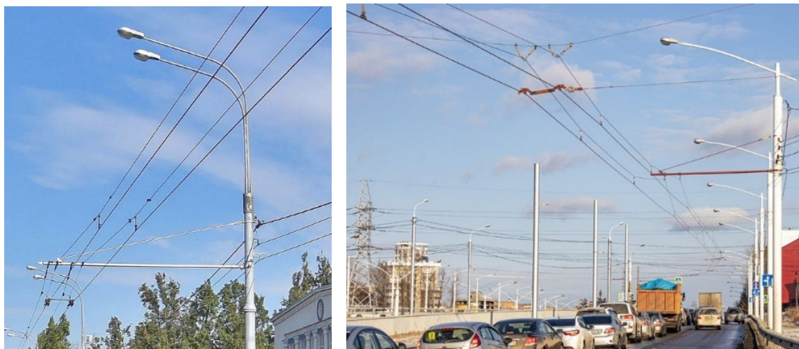
Рис. 5, 6. Цепная подвеска контактной сети троллейбуса
