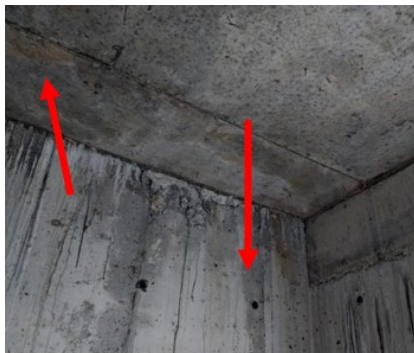
Рис. 1. Высаливание на поверхности монолитного железобетона вследствие применения добавок
