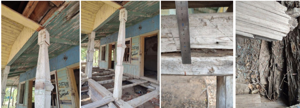
Рис. 5. Иллюстрация проведения строительно-технической экспертизы деревянных конструкций жилого спального корпуса, который был введен в эксплуатацию в 1913 г. (иллюстрации авторов) Fig. 5. Illustration of the construction and technical examination of wooden structures of a residential dormitory building that was put into operation in 1913 (illustrations by the authors)
